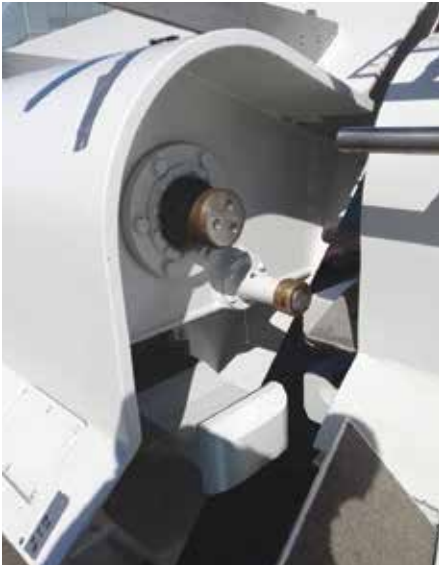
Het neuswiel, tussen de trekkende en duwende cilinder in, lijnt de draaiende brugdelen op.
