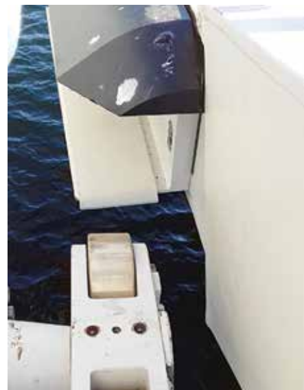
Bij sluiten draaien de staartwielen als eerste in de landhoofdbruggen.
