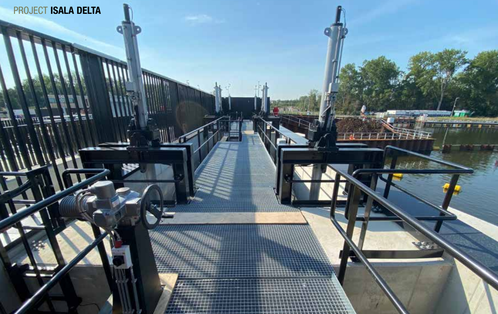
De hefcilinders van de Reeve-Spuisluis wachtend op hun ingebruikname.
